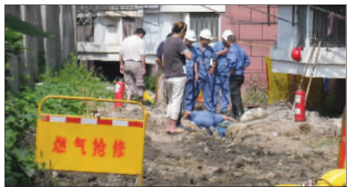
8月9日,南京应天大街的宇秦园小区也发生了一起施工挖破煤气管事故 本报资料图片
