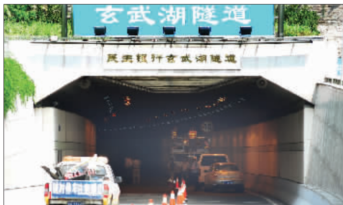
消音板脱落,工作人员正在维修。快报记者 施向辉 摄
