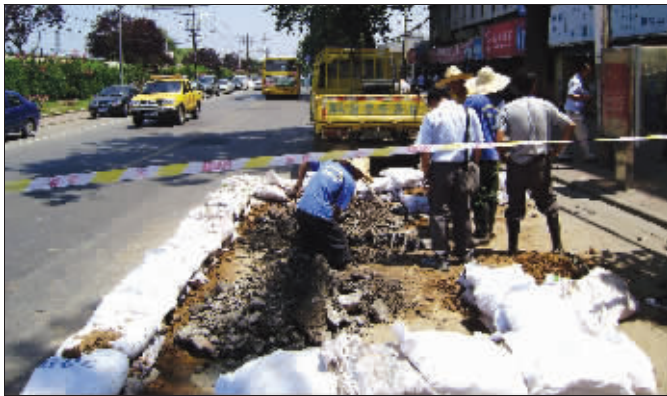
昨天上午,工作人员正在检查渗水原因 快报记者 是钟寅 摄
