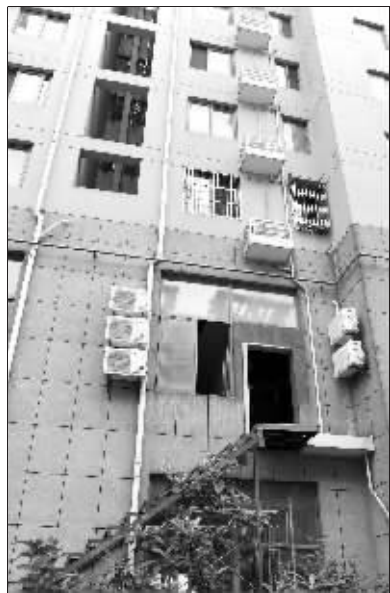
足疗店在二楼后墙壁上开了一道门,并搭了铁梯 快报记者 施向辉 摄
