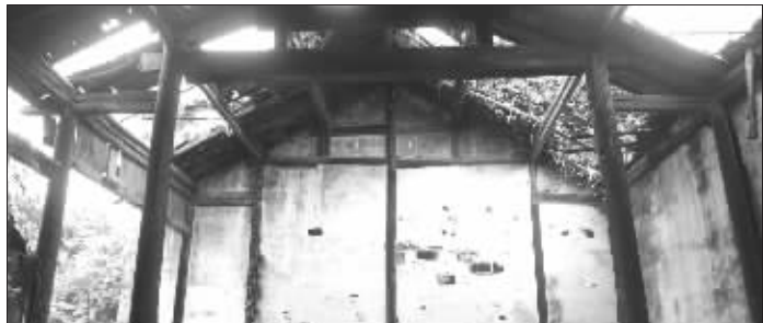
古祠堂大部分建筑倒塌，几成废墟 快报记者 辛一 摄
