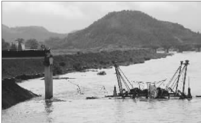
长风大桥出现断裂(7月6日摄) 新华社记者 裴立华 摄
