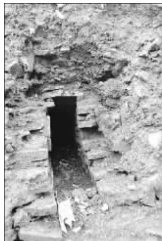
六朝的排水沟 资料图片
