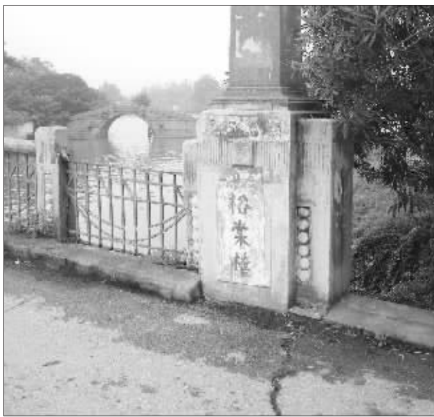
老裕棠桥残破不堪,很不安全
