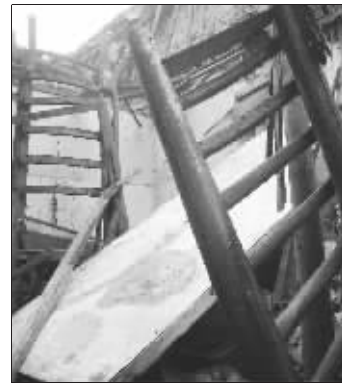
因年久失修而坍塌的房屋
