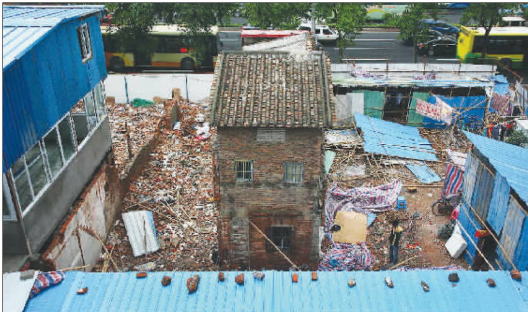
东风中路上车水马龙,苏三妹家危楼独立
