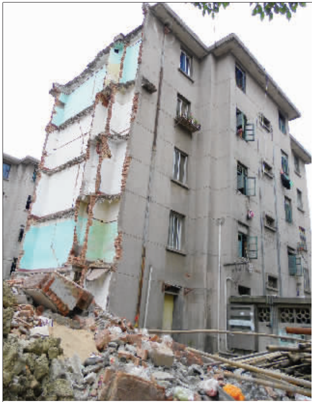
大楼被拆成这个样子,居民心里很不舒服——既不美观,梅雨到来后家里还可能渗水。
