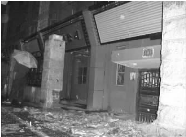
被偷偷砸坏的围墙
