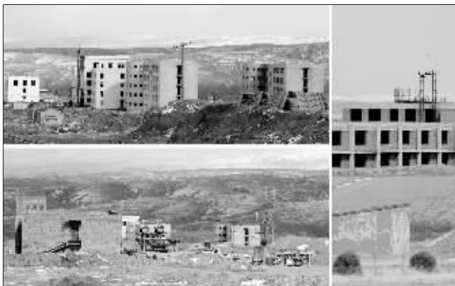
清水河县王贵窑山坡上的烂尾楼 新华社记者 任军川 摄
