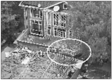
别墅紧靠调压房 快报记者 洪波 摄
