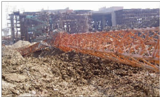
倒下的塔吊有七八十吨重 快报记者 孙玉春 摄
