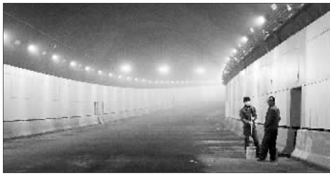
隧道的内装工程基本完工,等待路面摊铺沥青 快报记者 顾炜 摄
