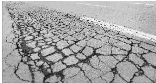
多处路面开裂严重 快报记者 施向辉 摄
