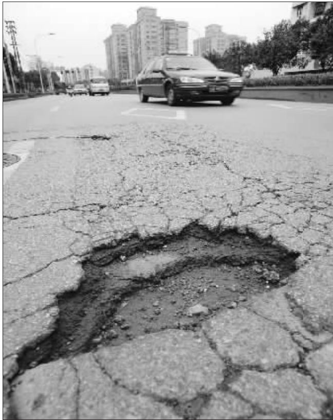
光华路上坑坑洼洼
