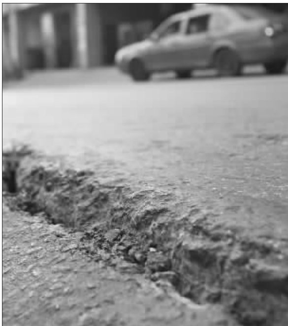
塌陷造成的路面裂痕
