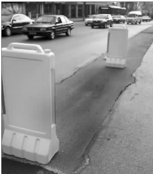
有的塌陷路段设置了黄色警示牌 快报记者 辛一 摄
