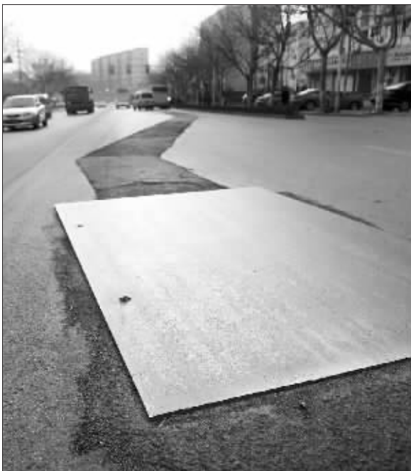
部分塌陷路段已采用钢板覆盖
