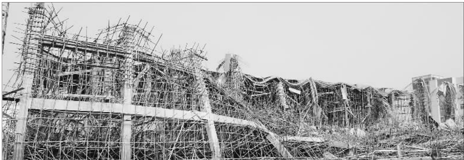
坍塌的厂房 快报记者 陈泓江 摄
