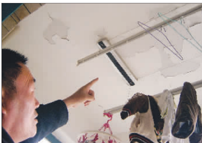
吴先生家主次卧、阳台等地方乳胶漆大面积脱落
