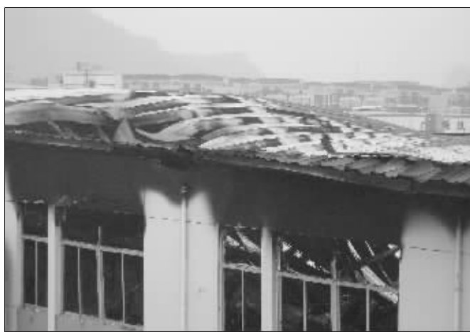
起火的车间,顶部被烧塌,里面一片狼藉
