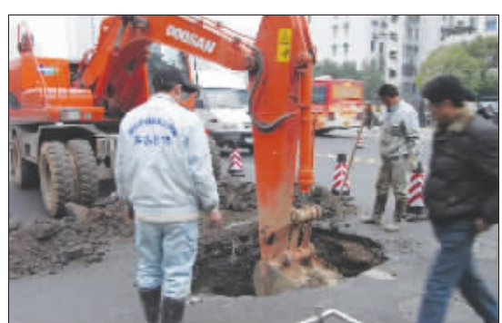
塌出来的大洞直径约一米。快报记者 赵守诚 摄
