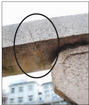
桥栏杆开裂处被粘了起来 快报记者 赵杰 摄
