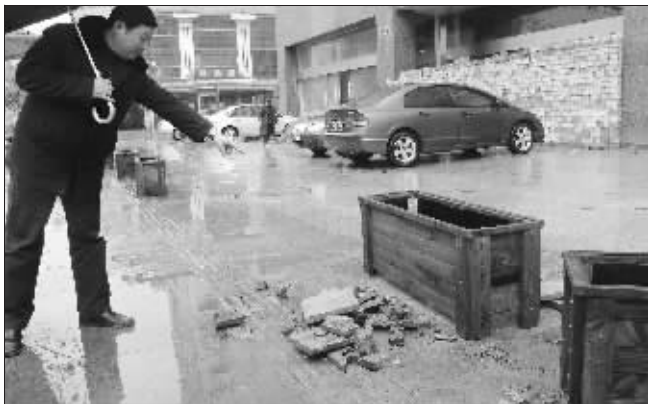
中山南路道板严重破损
