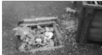
电信井盖被压碎
