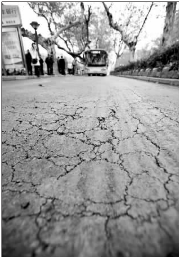
军区总院门口的路面开裂严重
