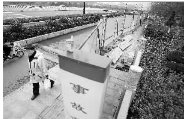
开裂的栏杆已被挡了起来 快报记者 顾炜 摄
