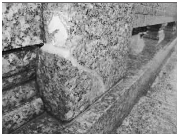
裂缝上糊了一层白色胶水 快报记者 是钟寅 摄
