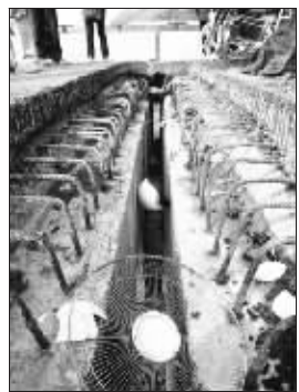
桥面挖开一个大坑
