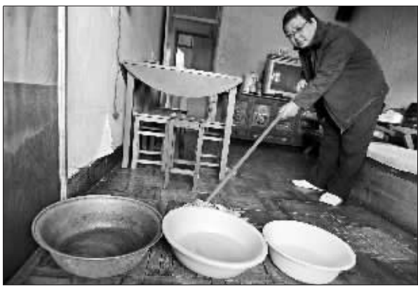
房顶漏水,501室的汤先生只能用盆接水 快报记者 施向辉 摄
