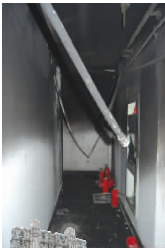
↑火灾现场的楼道被熏黑 ←大楼高得如同擎天柱 宋秉钊 摄
