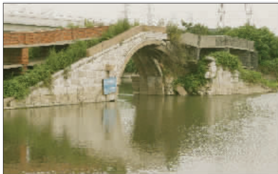
河上塘桥,又名永安桥、和尚塘桥,明正統年間重修,清嘉慶九年重建,位於禮嘉鎮蒲岸村和遙觀鎮遙觀村的交界處,它是眾多禮嘉鎮坂上人民心中的母親橋。但隨着歷史的變遷,這座拱橋如今已是破敗不堪,附近的居民希望有關部門能及時修繕,因為這樣的石拱橋已經不多了。 孫曉鋒 劉勁松 文/攝
