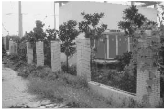
泵站围墙4段铁护栏不见了
