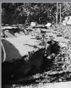
被冲毁的道路 新华社记者 陈键兴摄
