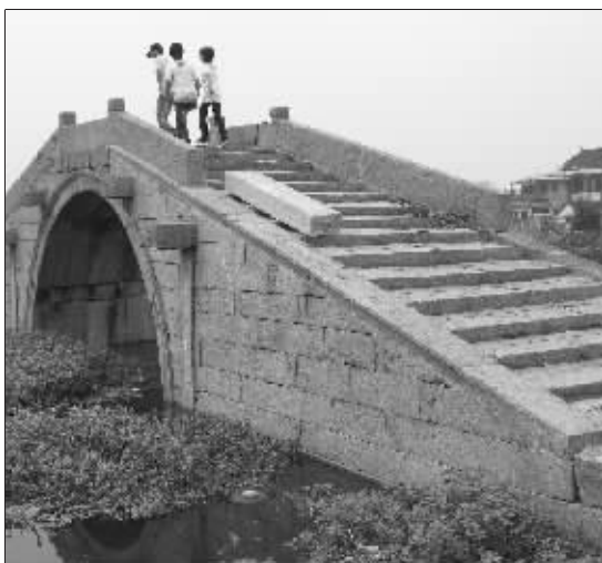
古桥的桥梁已出现坍塌
