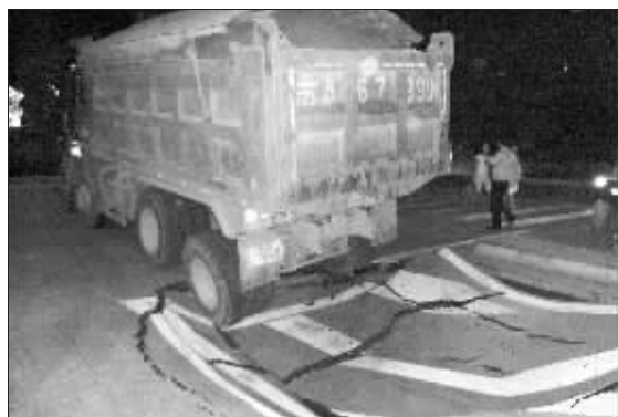
渣土车尾部路基突然塌陷 快报记者 是钟寅 摄
