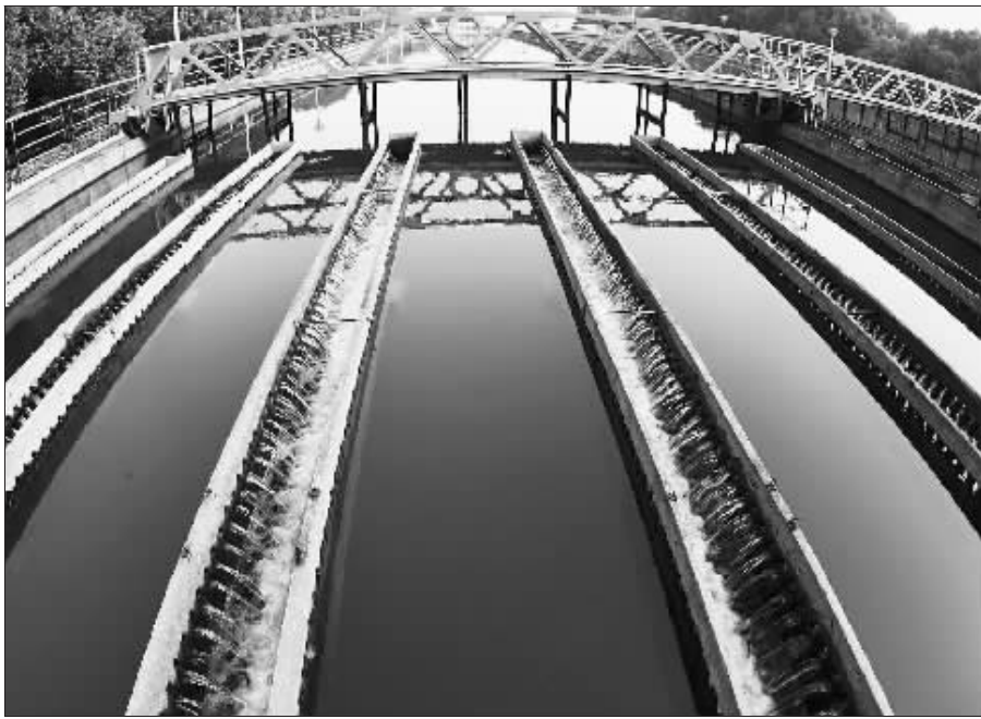
宁波一自来水厂水处理池 摄影 张和平
