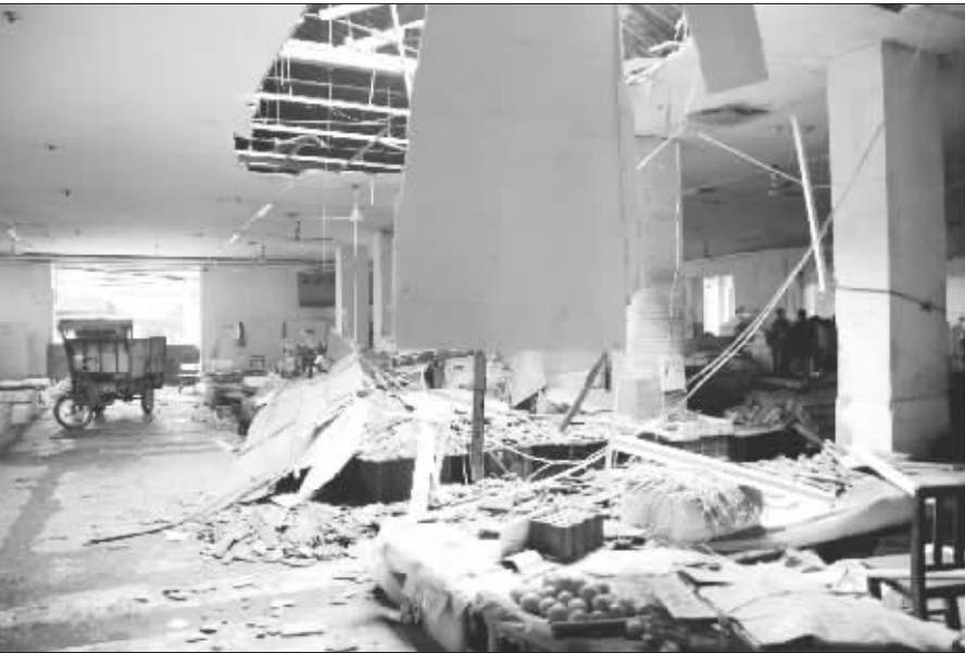
新民桥菜场屋顶坍塌现场
