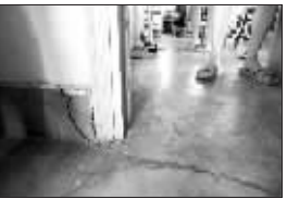
内墙地面开裂
