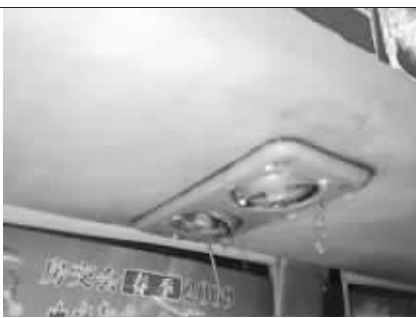
车上空调在漏水 (网友供图)
