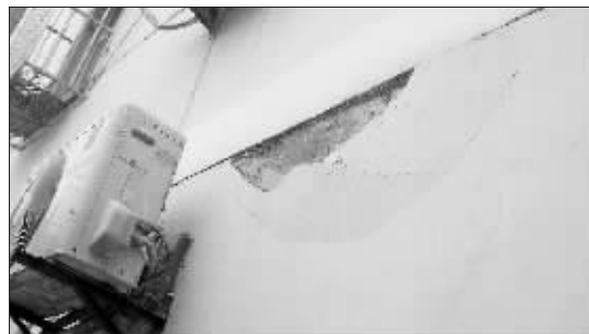
居民楼墙面出现脱落
