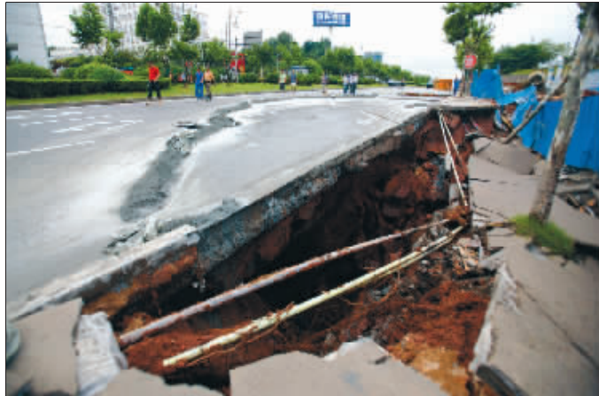
花神大道望江矶一处路面塌方(左),塌方的土石落入一旁的大坑内(右)
