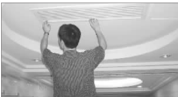
空调安装不当,用起来麻烦很大 资料图片
