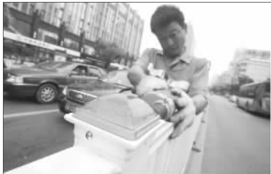
昨天,工作人员正在快车道的护栏上安装反光装置。南京交管部门近期将集中对市内的主干道安装这种太阳能反光灯,减缓夜间行车的视觉疲劳。快报记者 唐伟超 摄
