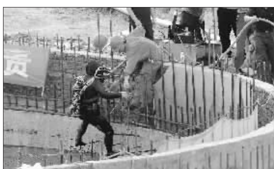
6月11日,刚结束一次潜水搜救的潜水员从事发的排海管竖井口出水 新华社记者 姜恩宇 摄
