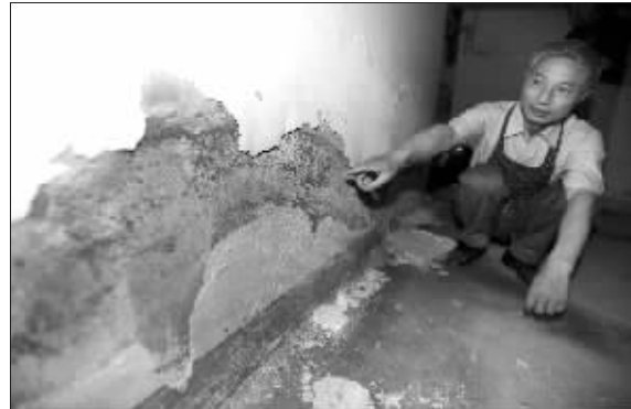
地下室墙上留下的黑色水迹
