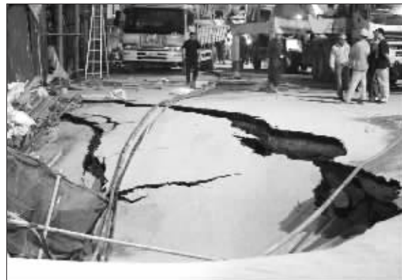
地铁工地塌陷,凹陷最深处超过5米 快报记者 唐伟超 摄
