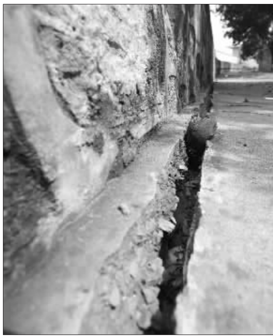
江堤上的裂缝能塞进手指 快报记者 唐伟超 摄
