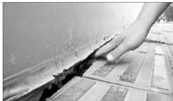
裂缝能插进手掌,市民挺担心 快报记者 是钟寅 摄
