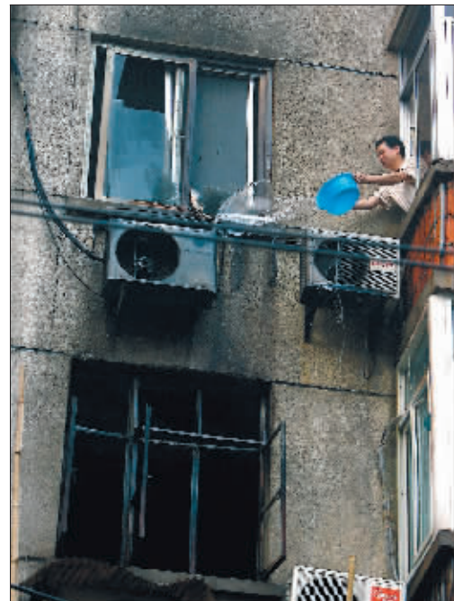
4楼失火,5楼空调外机遭殃 快报记者 顾烁 摄
