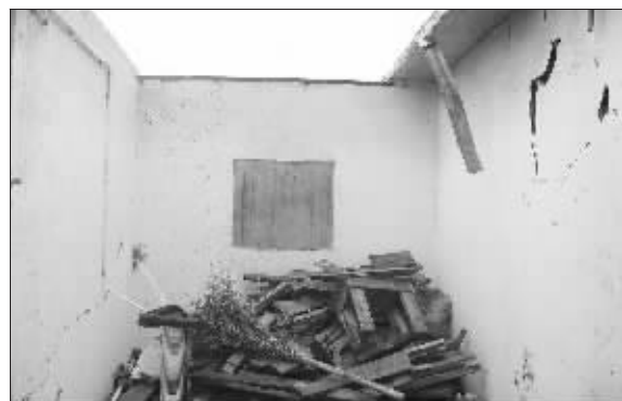
锅炉房的墙壁上出现了裂缝,顶上原有的天棚已被炸飞了
